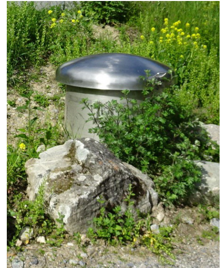
Links: Anlage in Gebäude Mitte: Anlage im Schacht Rechts: Schacht von aussen
