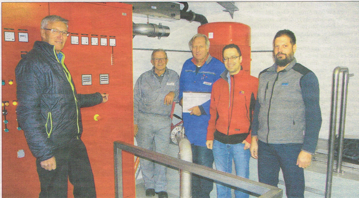
Freuen sich über das gelungene Werk (von links): Hans Hasler, Bauvorstand Gemeinde Sufers, Werner Sigris, Firma Sigris AG (Turbinenlieferant), Hans Kobel, Kobel Elektrotechnik AG (Lieferant Steuerung), und Oliver Sommerau, KHR.
